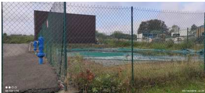
Bâche de réserve incendie crevée
