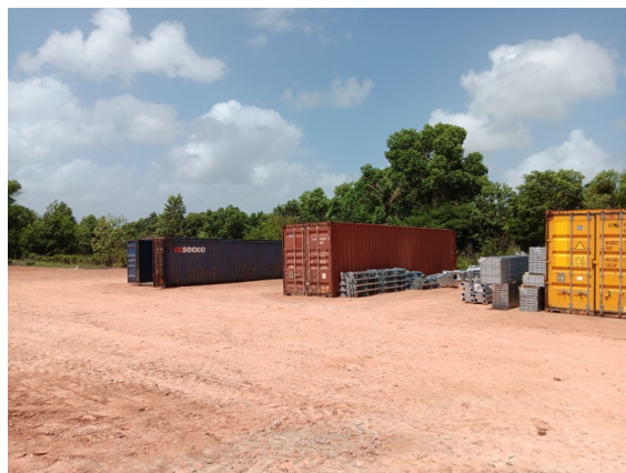
Containers Installation de traitement
