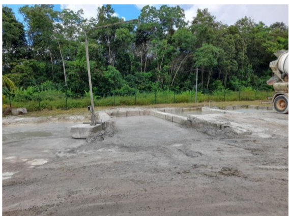
Bassins de décantation
