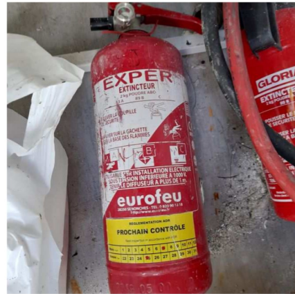
Extincteur (VGP au 07/25)
