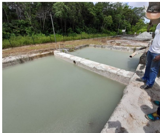
Bassins de décantation
