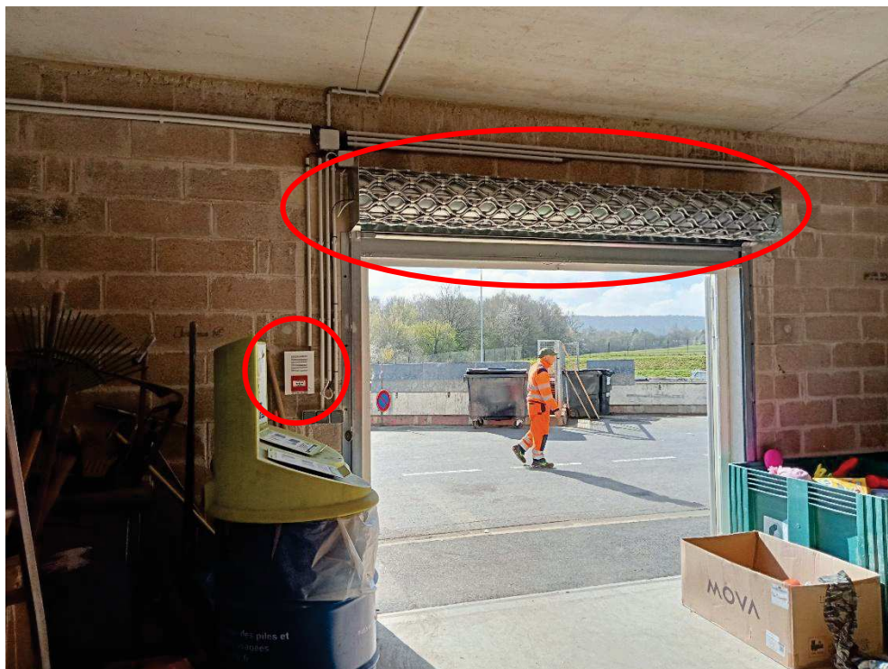
Système de détection incendie à côté de l’ouverture et rideau dentelle
