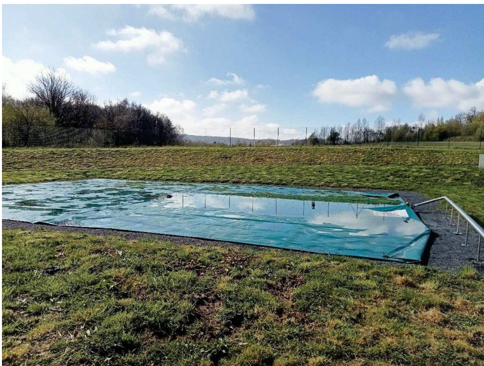
Citerne permettant le confinement des eaux en cas d’incendie
