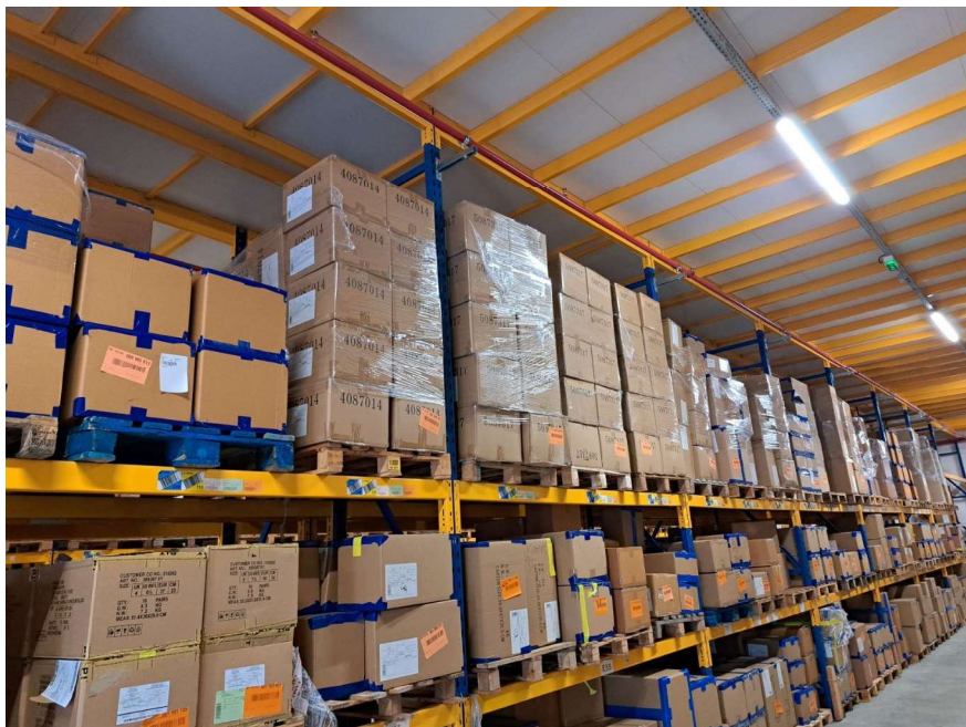
Cellule 4 niveau inférieur (espace libre réduit entre le sprinklage et le niveau du stockage)
