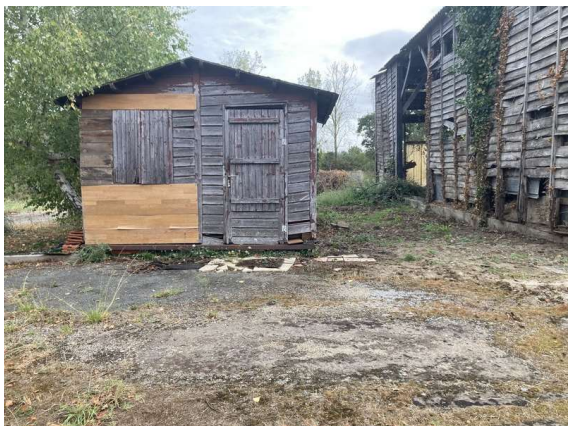
Hangar et cabanon délabré
