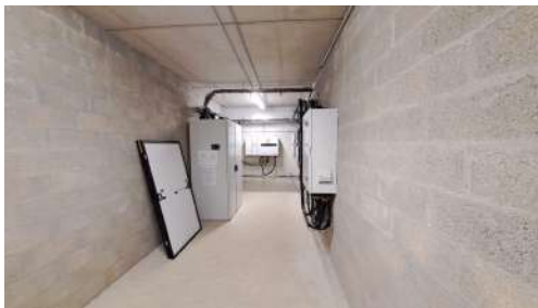
Dispositif EI local onduleurs vue d'ensemble
