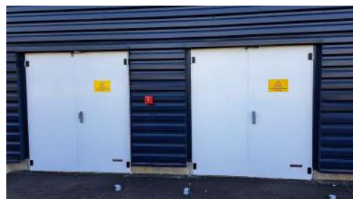
Signalisation CV locaux techniques
