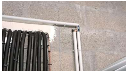
Dispositif EI local onduleurs étanchéité câbles
