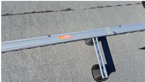
Signalisation câbles DC toiture
