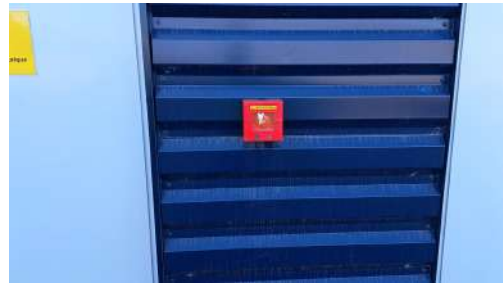
Dispositif de coupure locaux techniques voyant lumineux
