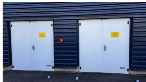
Dispositif de coupure locaux techniques
