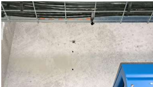
Dispositif EI local onduleurs étanchéité trou
