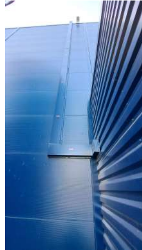
Signalisation câbles DC descente de toit
