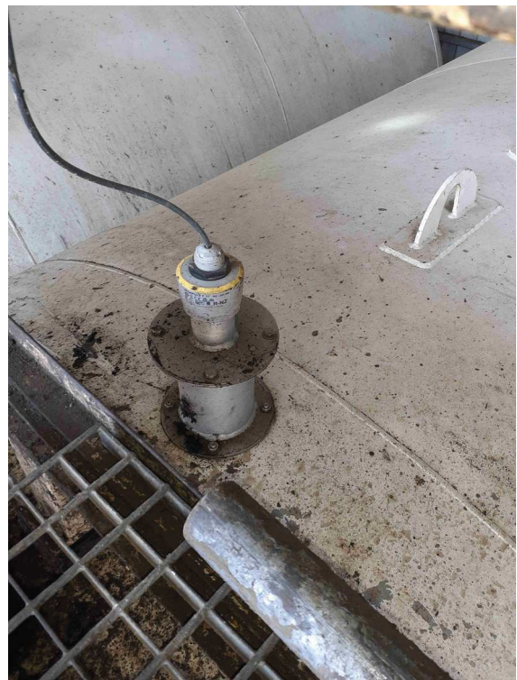
capteur niveau cuve 2
