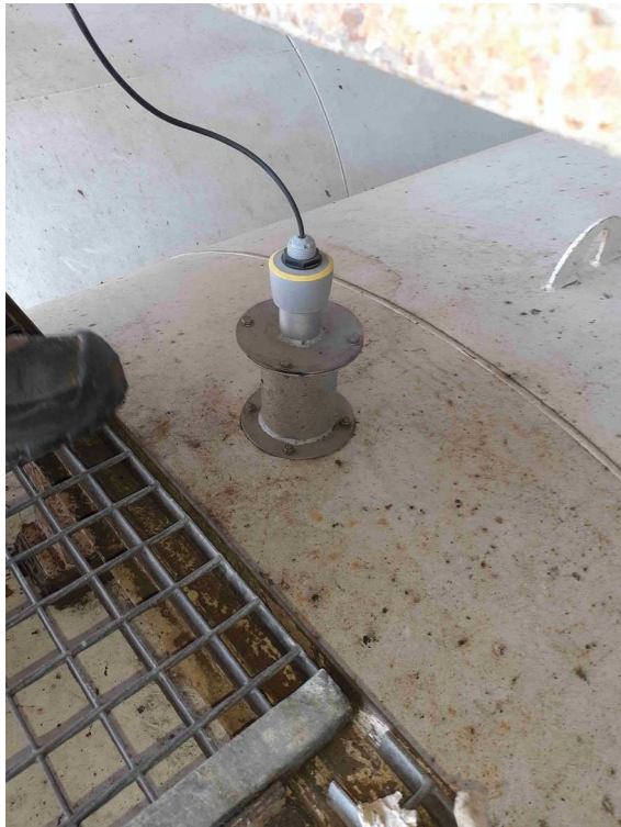
capteur niveau cuve 3
