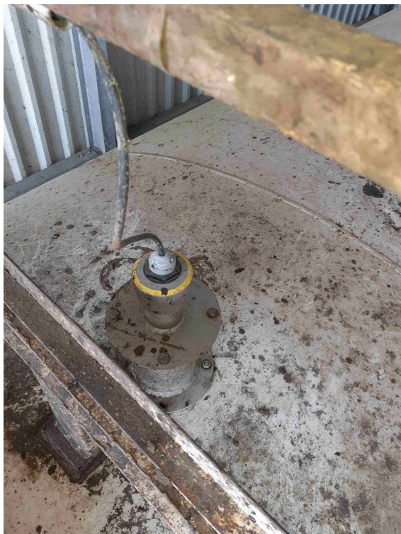
capteur niveau cuve 1
