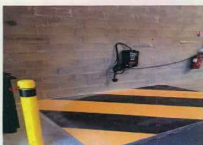
Zone de charge cellule 2
