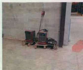
Zone de charge Cellule 1
