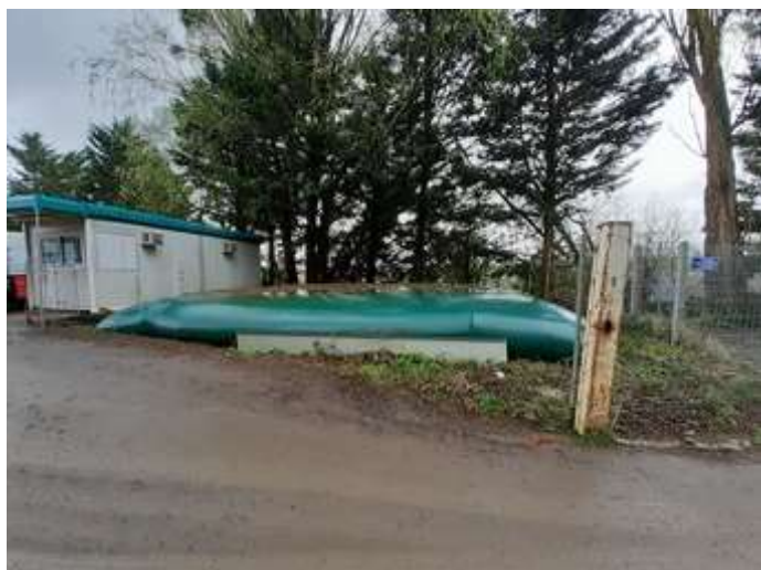
Réserve incendie d'une capacité de 120 m 3 située à l'entrée de l'installation
