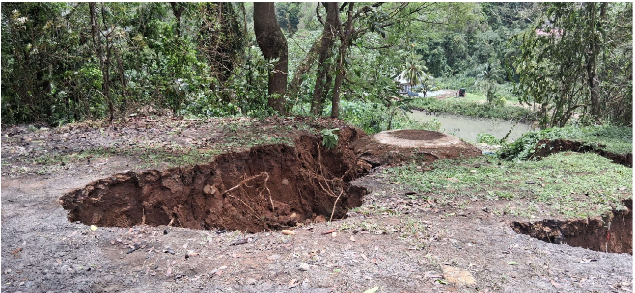
Figure 4: Glissement de terrain au droit de la lagune B (vue de la lagune B vers la lagune D)
