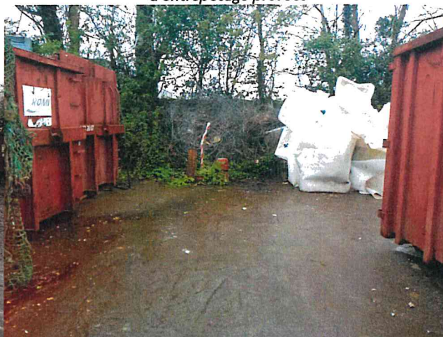
Photo 6 : Poteau incendie non entretenu et difficilement accessible en raison de l'étroitesse du chemin d'accès entre les bennes
