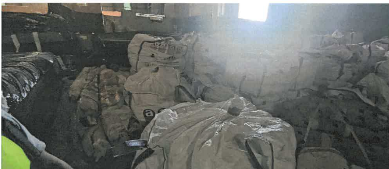
Photographie n° 1 (porte d'entrée et zone d'entreposage de déchets d'amiante dans l'espace non cloisonné)
