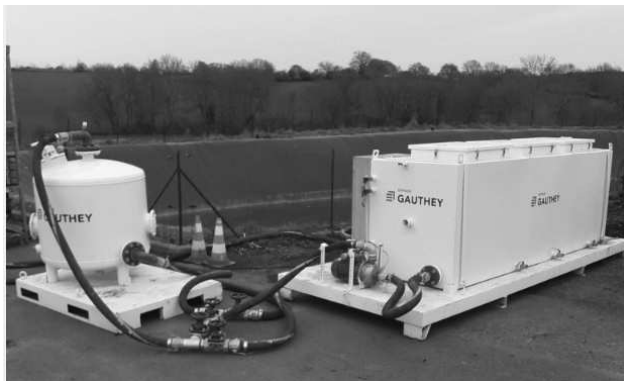
Station de prétraitement des eaux
