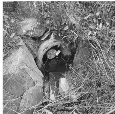
Obturbateur et fossé montrant absence d'incidence sur le fossé voisin
