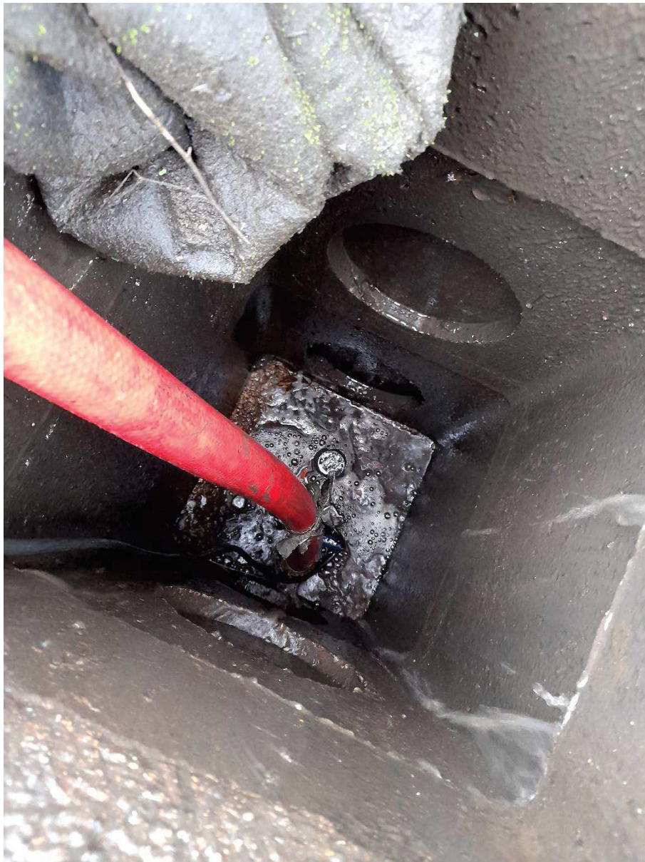
Pompe de relevage
