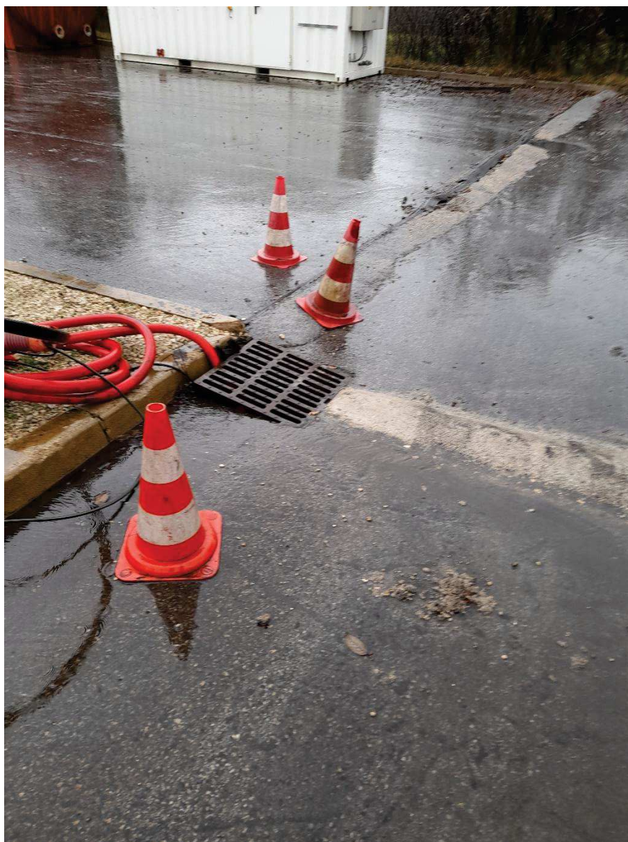
Regard contenant la pompe de relevage
