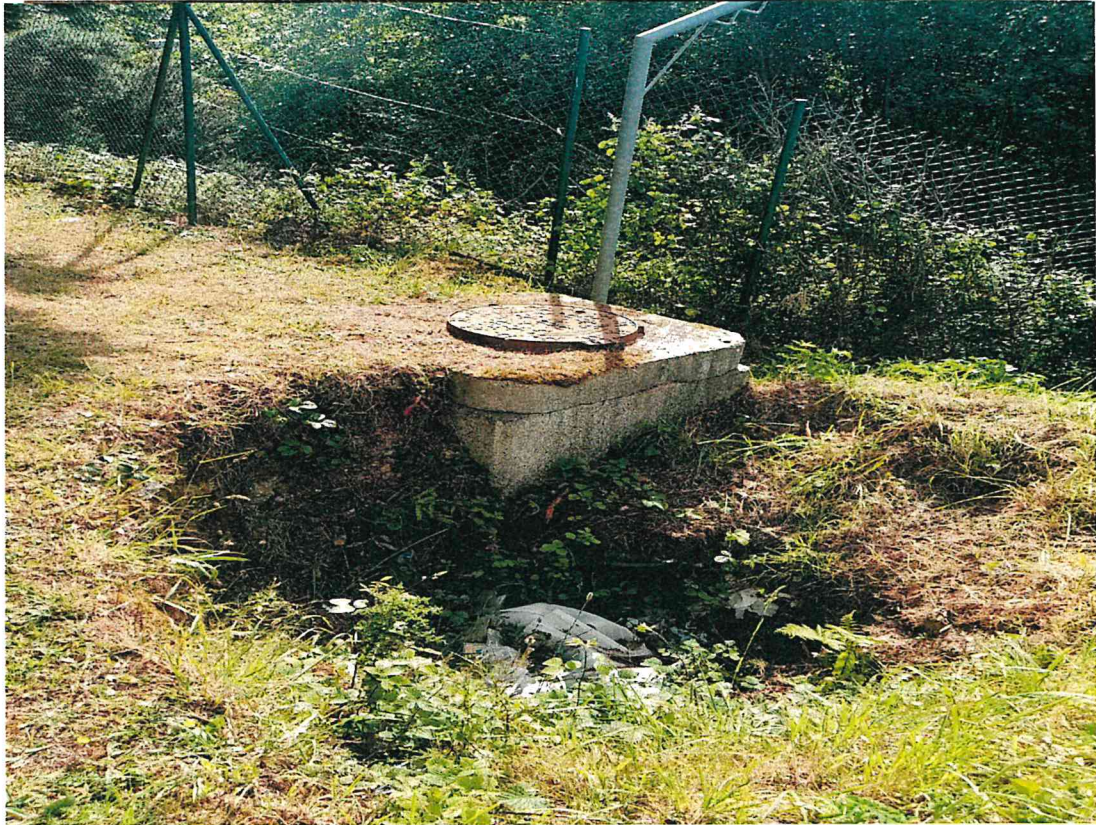
Photo 5 : point de commande locale de la vanne d'obturation du bassin de confinement, non identifié et dépourvu de la clé permettant d'actionner la vanne
