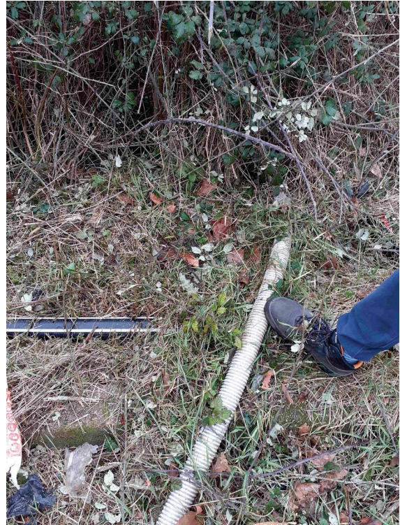
tuyau de rejet au milieu naturel
