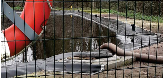
lagune niveau haut aspiration pompe arrosage andains
