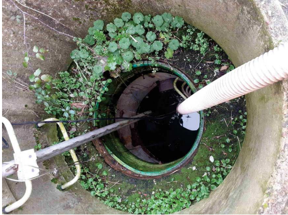
intérieur du puits avec végétation et pompe immergée
