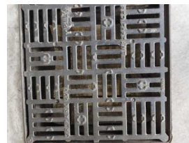
Dispositif de récupération des GPI (tamis)
