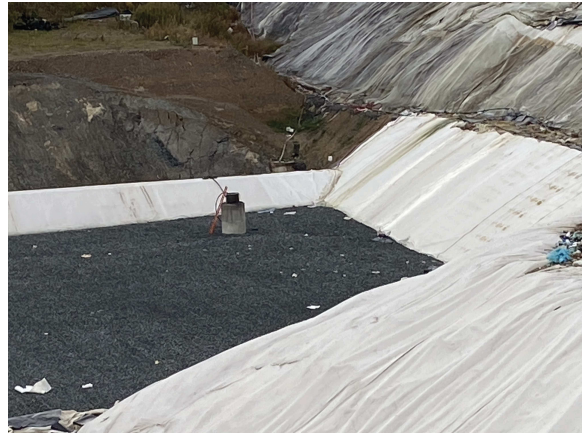
Puits de pompage des lixiviats du casier 4.1
