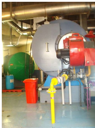
Figure 3: Chaudière de puissance 5,815 MW
