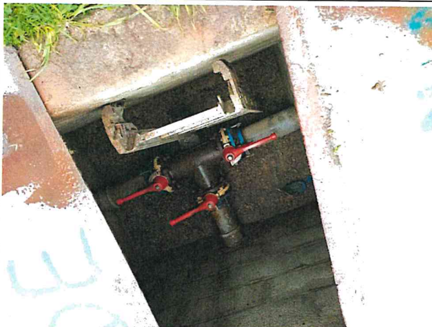
Vannes enterrées à proximité du bassin
