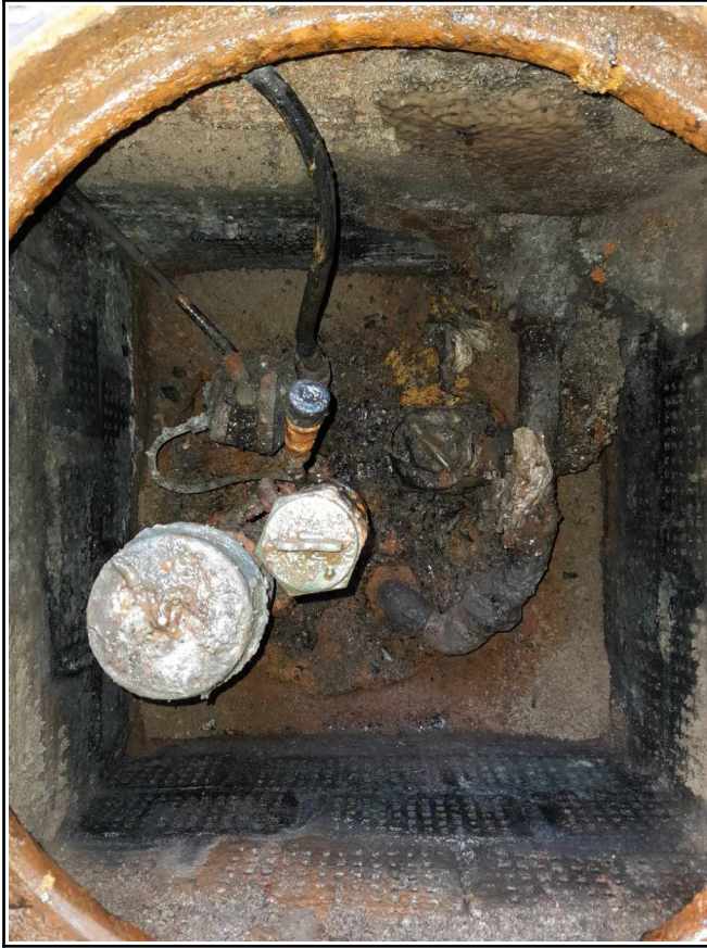
Photo n°6 : Regard de la cuve SP 95
