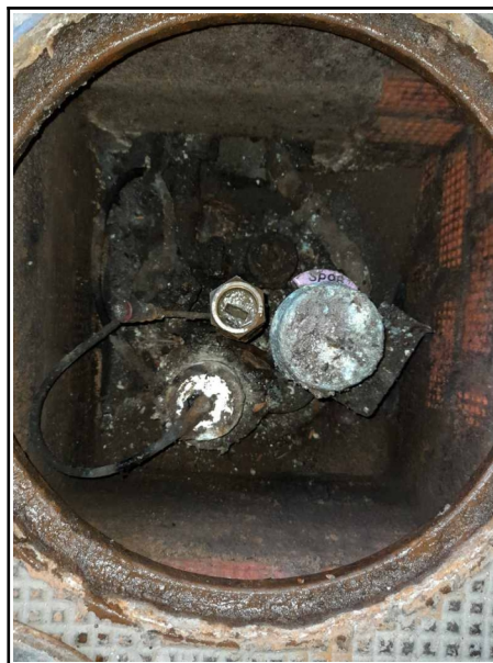
Photo n°5 : Regard de la cuve SP 98
