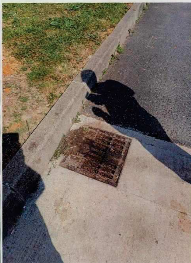
Grille de l'aire de dépotage obstruée
