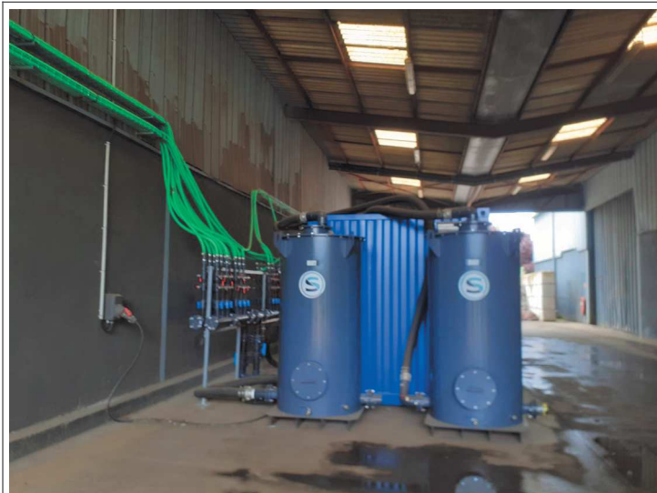
Unité de venting – Filtre à charbon actif
