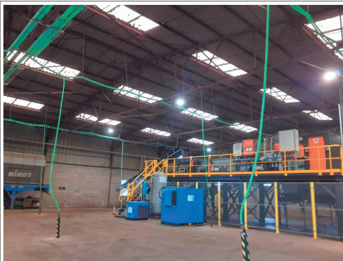
Installations de venting à l'intérieur du bâtiment 3 ( source de pollution concentrée PC1)
