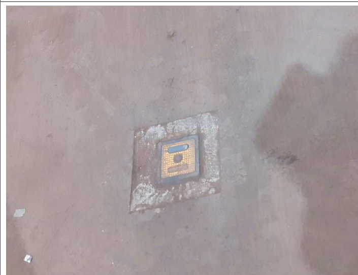
Piézair de contrôle
