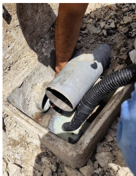
Pompage des effluents au niveau du regard, la descente d'eau pluviale se trouve juste derrière les cuves de recyclage d'huiles
