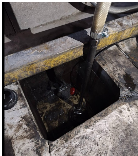
Regard de pompage des huiles usagées (regard potentiellement non étanche), voisin d'une descente d'eau pluviale (photo ci-dessous)
