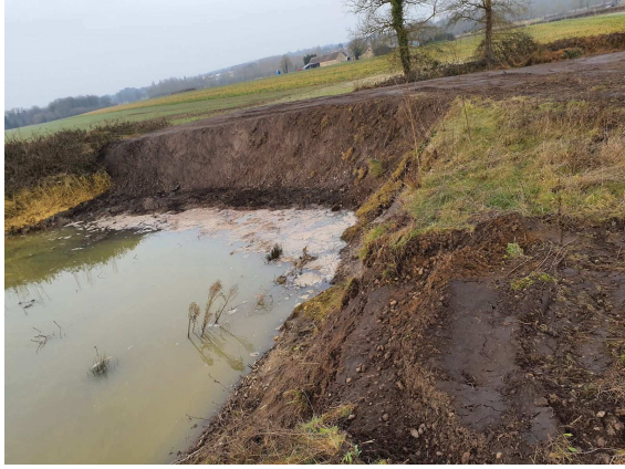
brèche colmatée – vue de l'intérieur du bassin
