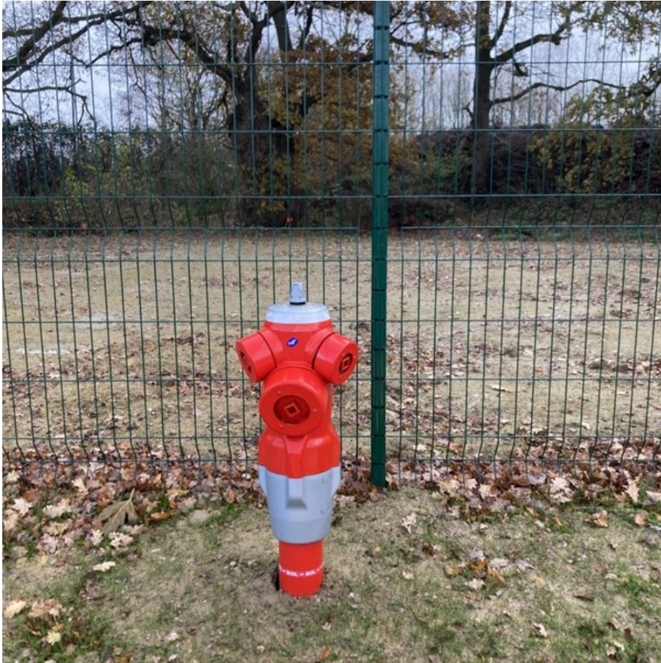
Poteau incendie neuf en bas de quai
