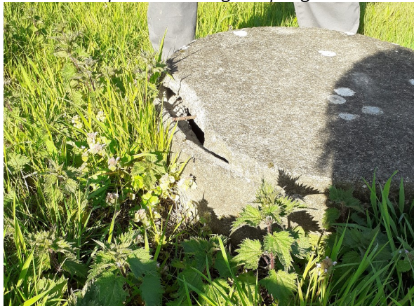
Capot endommagé du forage F2
