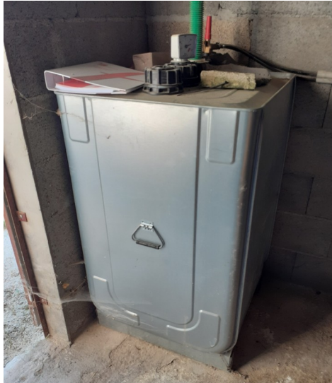
Cuve de fioul à double paroi
