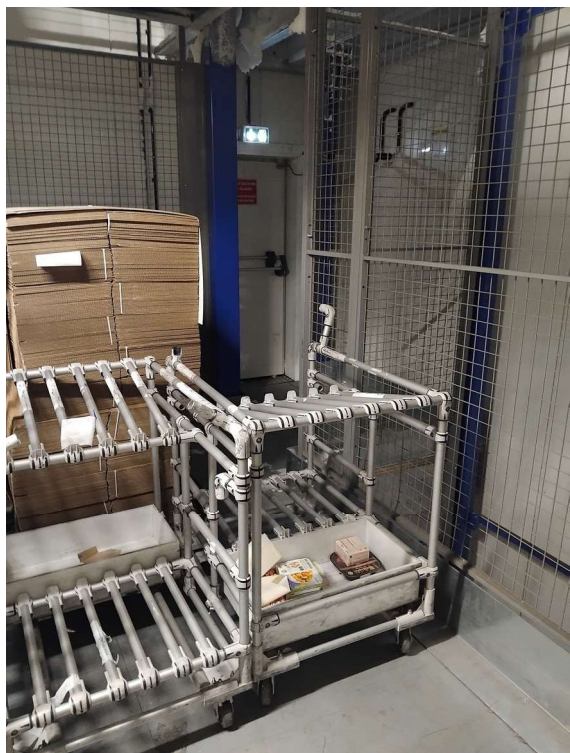
Sortie de secours du 1er étage encombrée
