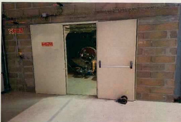
Figure 7 : Porte coupe-feu chaufferie
