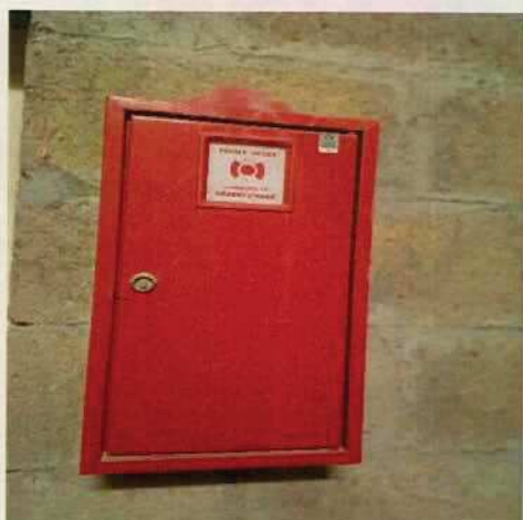
Figure 6 : Commande de désenfumage
