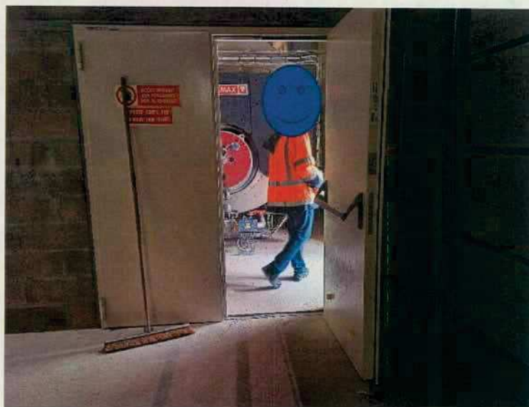
Figure 8: Porte coupe-feu chaufferie
