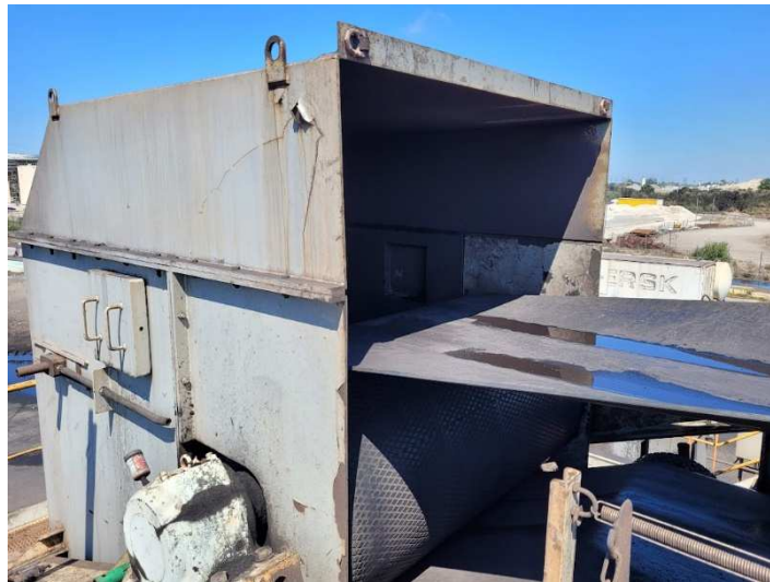
Système de captage au niveau de la bande L5
