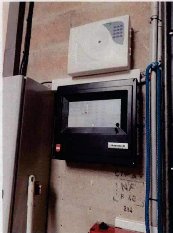
CENTRALE DETECTION INCENDIE
