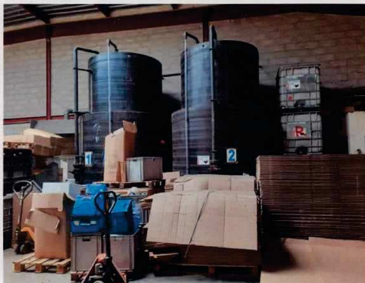
RESERVOIRS STOCKAGE DES BAINS
