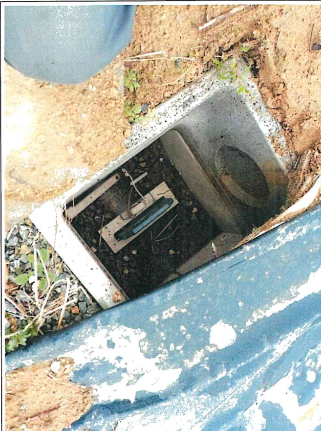
Vanne à commande manuelle locale, d'obturation du bassin de confinement,
