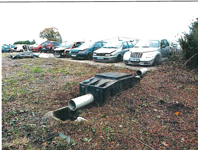
Séparateur à hydrocarbures collectant les eaux de ruissellement sur la dalle d'entreposage des VHU non dépollués vers le bassin de confinement situé en aval
