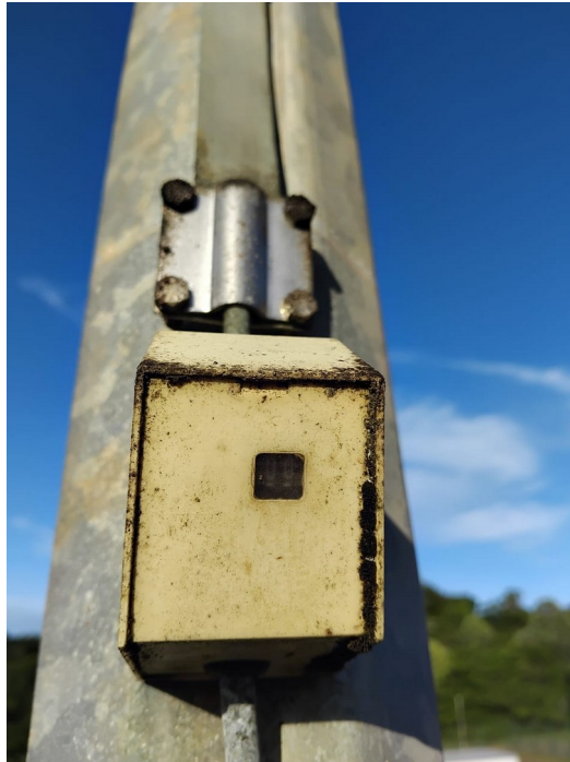
Compteur foudre du dépôt
