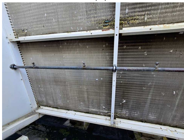
Illustration de l'équipement, avec rampe et buses de pulvérisation devant l'échangeur de chaleur.
