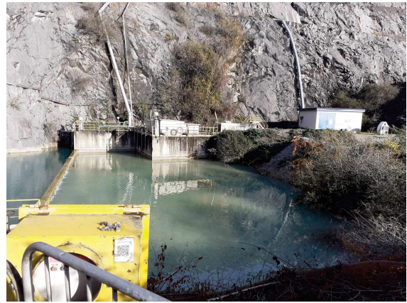
pompe avec double tuyauterie
