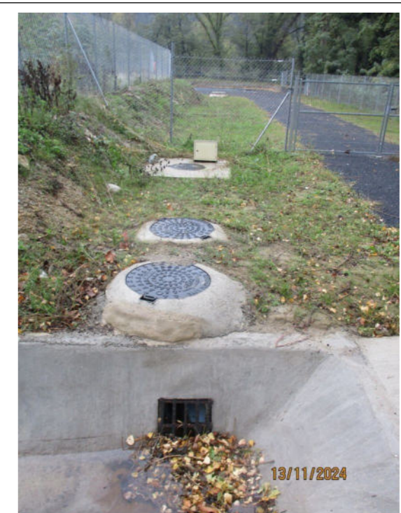
Regards du séparateur d'hydrocarbures
