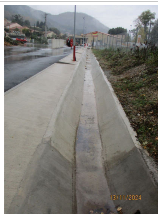
Caniveau de collecte des eaux pluviales susceptibles d'être polluées
