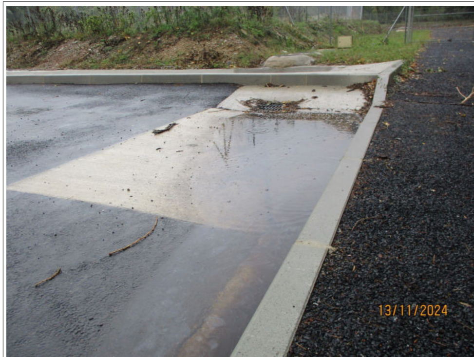
Avaloir débouchant dans le caniveau des collectes des eaux pluviales susceptibles d'être polluées – On remarque des irrégularités dans la flaque d'eau caractéristiques d'une contamination aux hydrocarbures ou leurs dérivés
