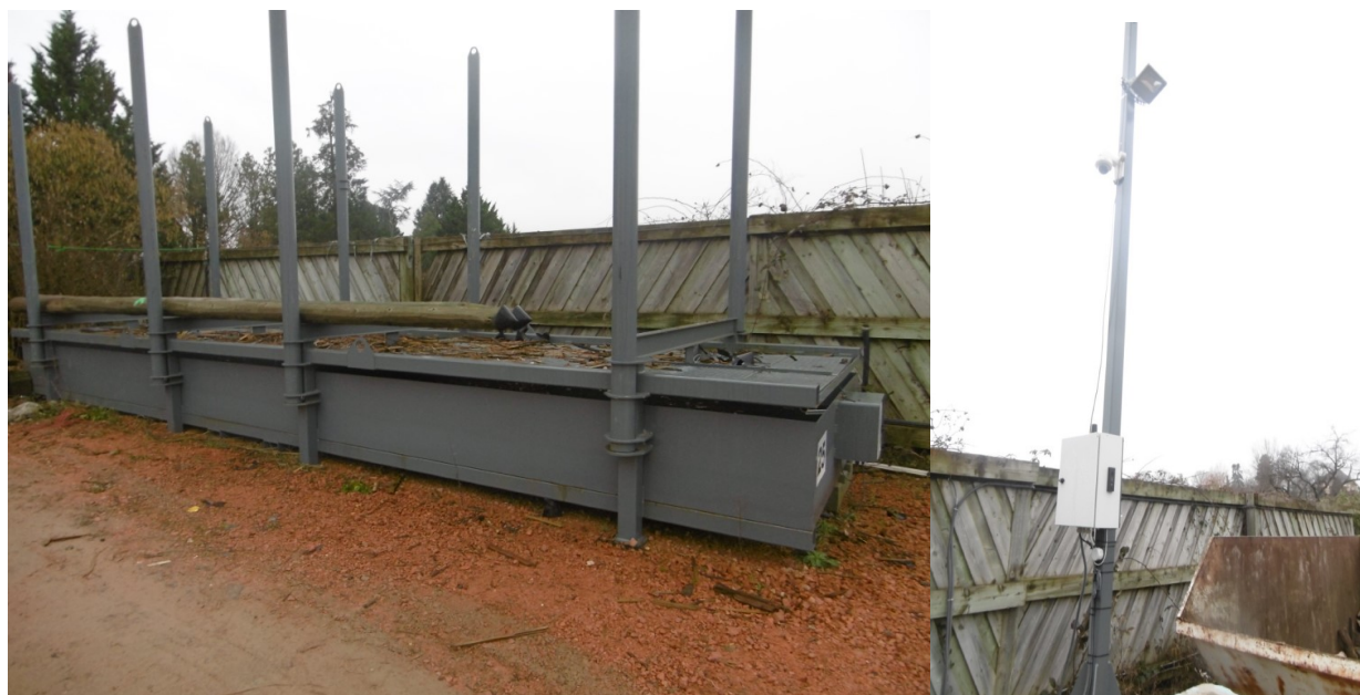
Vues du rack de stockage et du mât de surveillance
