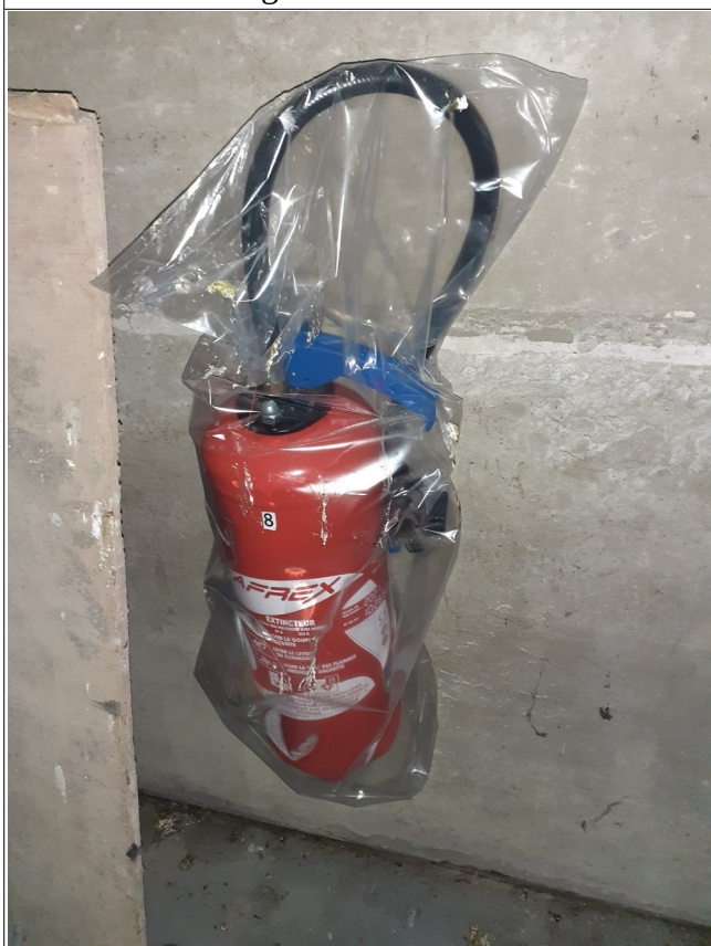
Extincteur vérifié en août 2023 mais encore emballé d'un film plastique
