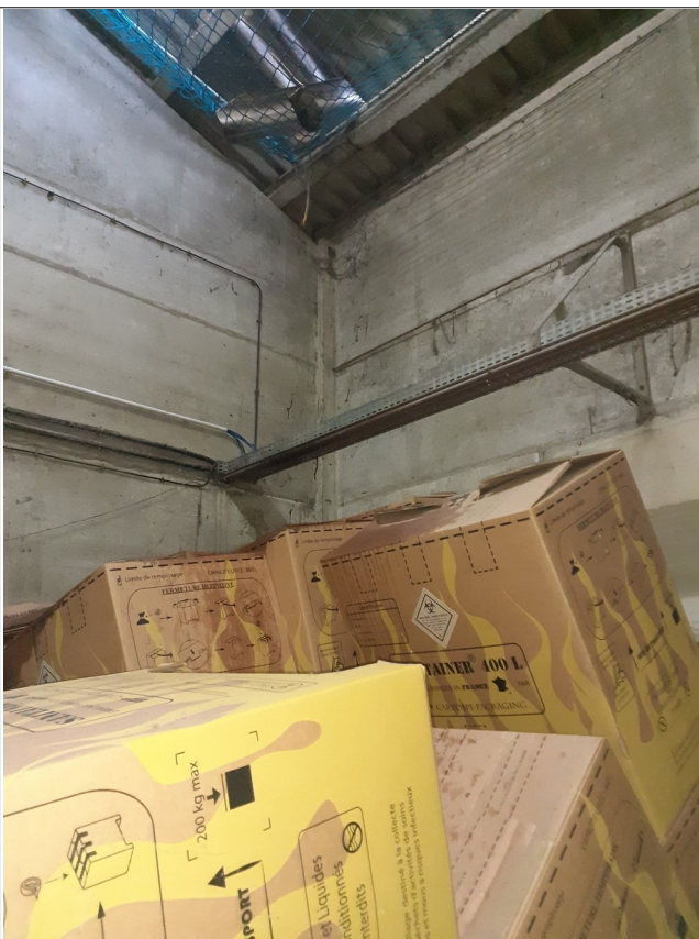
Fuites d'eau au niveau de la toiture mouillant les cartons stockés en dessous
