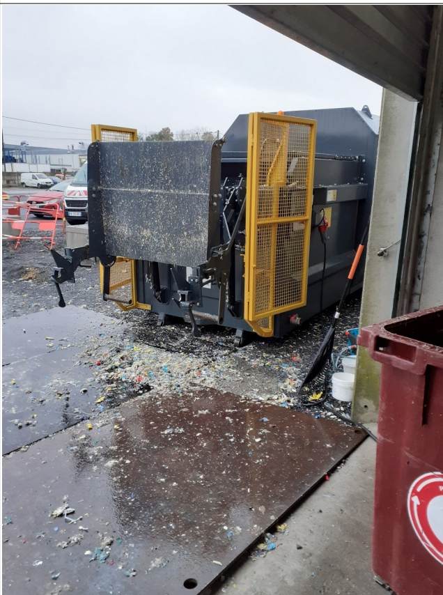
Compacteur monobloc destiné à conditionner les déchets désinfectés : en panne
