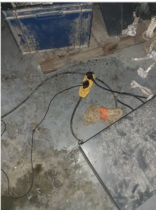
Fuites de la toiture au sol, à proximité immédiate d'installations électriques
