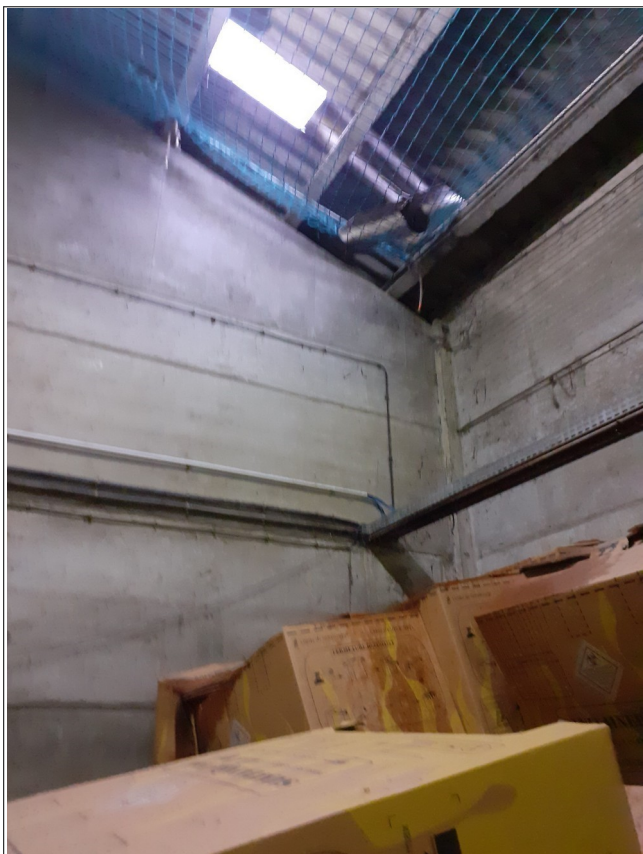
Présence d'un filet sous la toiture pour éviter des chutes d'éléments de cette dernière
