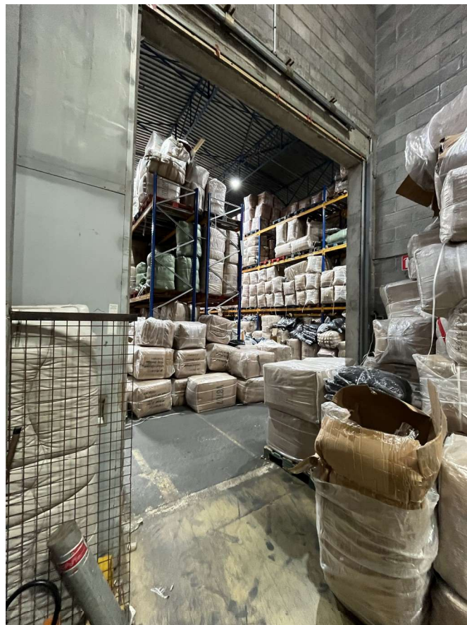
Annexe 5: Porte coupe-feu obstruée sur la droite par une palette de stockage, empêchant sa fermeture
