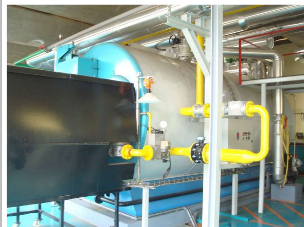
Figure 2: Chaudière d'une puissance de 6,978 MW
