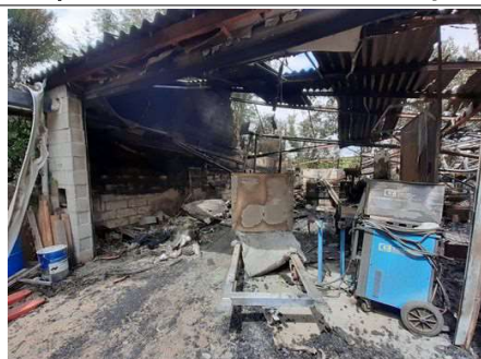
Atelier de maintenance où a démarré l'incendie
