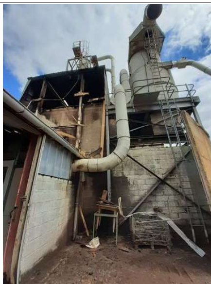
Silo de copeaux de bois en provenance de l'aspiration des ateliers
