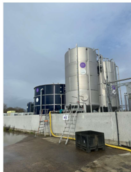
Photo n°1 : Rétention R2 contenant 3 cuves
