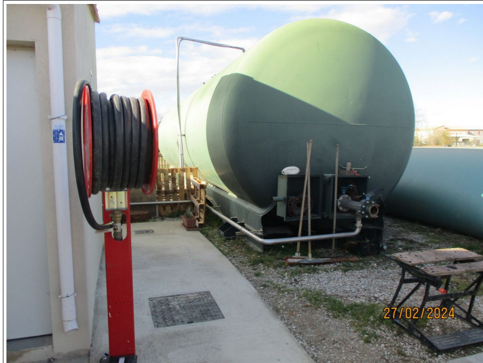
RIA situé à l'entrée du site, près du local d'accueil des usagers de la déchèterie
