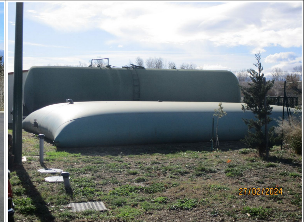
Citerne souple de 120 m 3 (premier plan) + citerne « wagon » de 110 m 3 (au second plan) d'eau destinée à la lutte contre l'incendie
