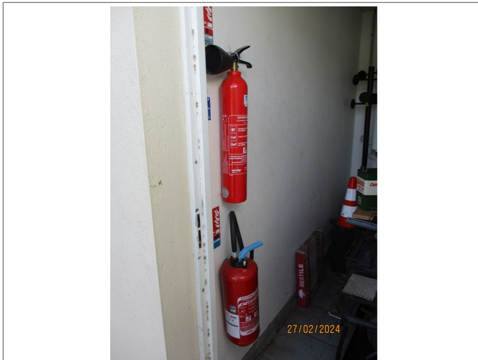
Extincteurs présents dans le local limitrophe au local d'accueil des usagers de la déchèterie
