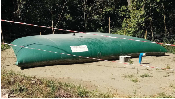
Réserve incendie (60 m3) avec point de raccordement.
