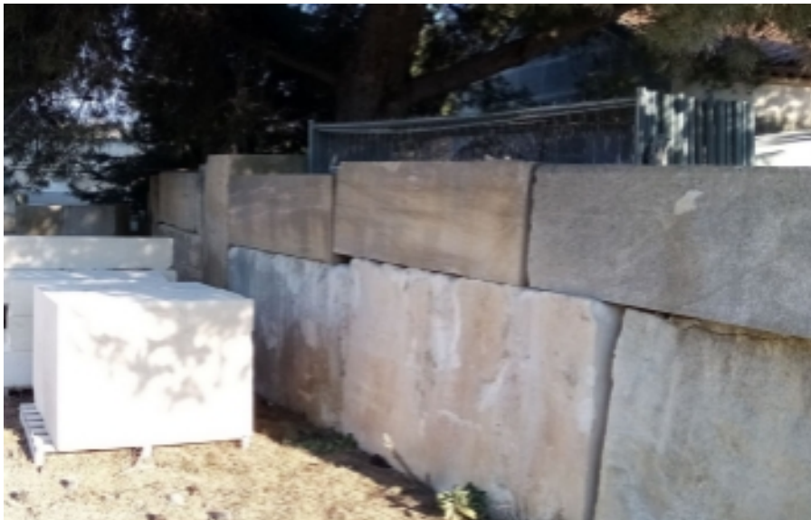
Mûr de bloc réalisé à proximité de l'habitation du tailleur de pierre
