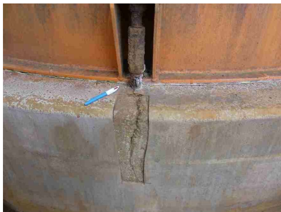
Photo du massif situé dans la rétention 21RE40
