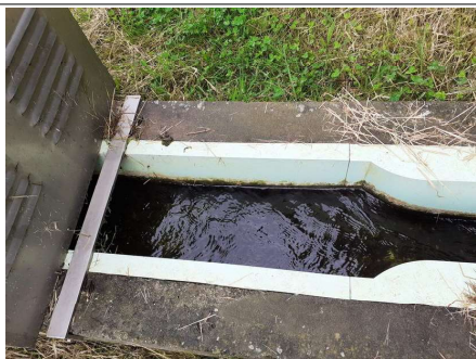
Canal de rejet encrassé
