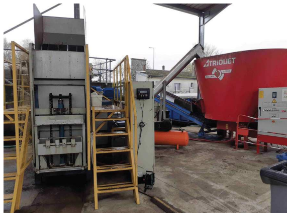
installation de mélange déchets alimentaires et broyats végétaux
