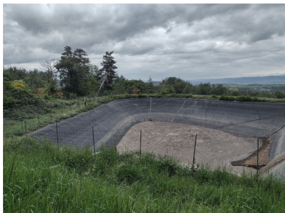
Photo 1 Fosse géomembrane supérieure
